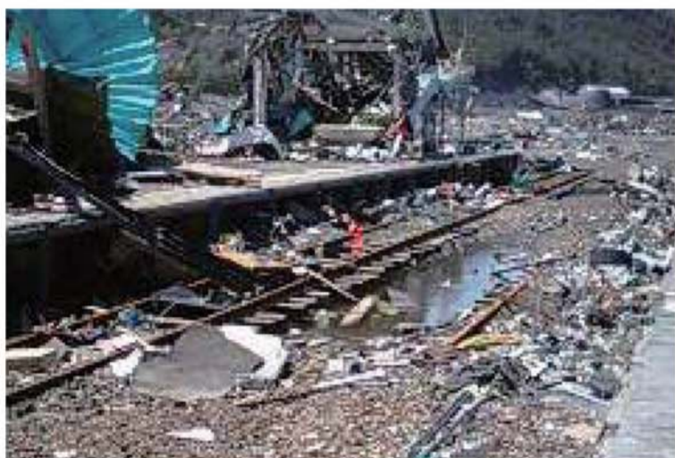
多くの駅舎や総延長 22キロ分の線路が被害を受けました。
